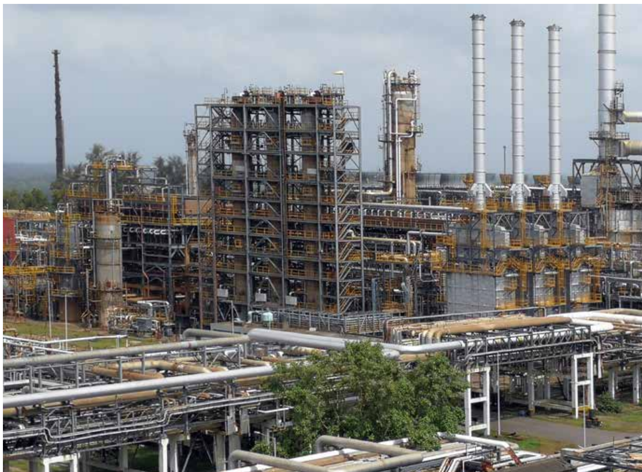
Raffineria di Mangalore Unità Hydrocracking n° 1
