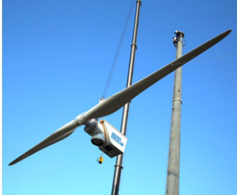
← L’impianto eolico di Cancellara, Basilicata. ↑ Installazione della turbina da 60 kW, Cancellara, Basilicata.
